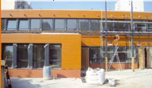
CS Marnaudes - les travaux continuent, nous vous accueillons maintenant dans la partie réhabilitée.
